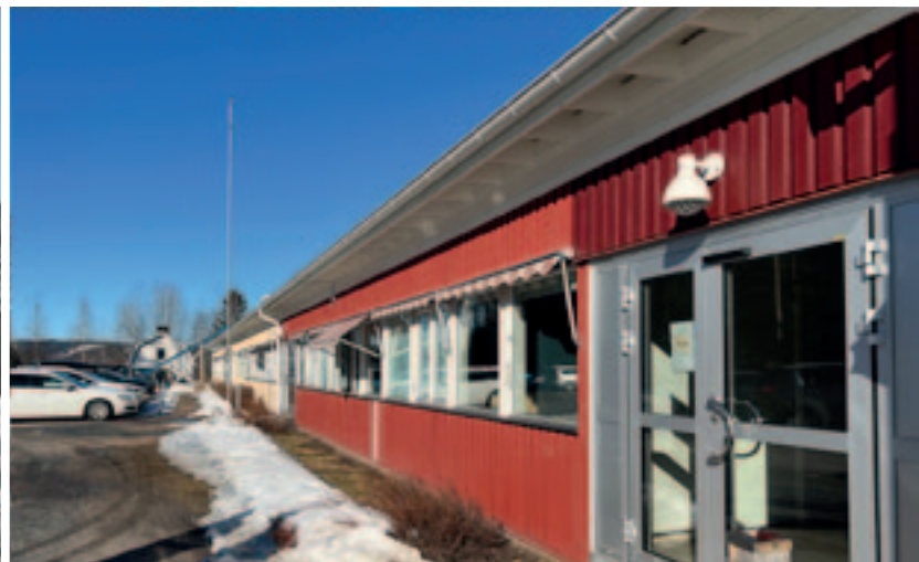
Norra delen av Kvistbergsskolans nedre plan byggs om till moderna ändamålsenliga skollokaler för hemkunskap, musik och slöjd.
